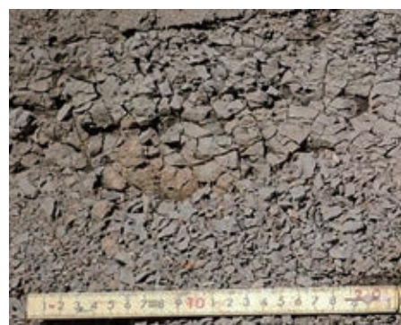
写真-2 スレーキングにより細粒化した泥岩
