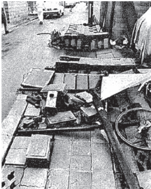
図-5 宮城県沖地震で多発したブロック塀倒壊写真 (引用文献(5))
